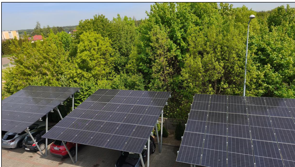
Zdjęcie 2. Mikroinstalacja fotowoltaiczna na konstrukcjach typu car-port przy urzędzie Gminy Fabianki zamontowana w 2025 r.
